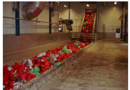
Storage & transport-floor mounted in a concrete pit Lager- und Transportboden, installiert in einer Betongrube
